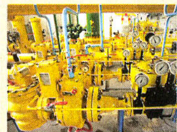
Les vannes de distribution de Gaznat pour Aigle. F. CELLA
